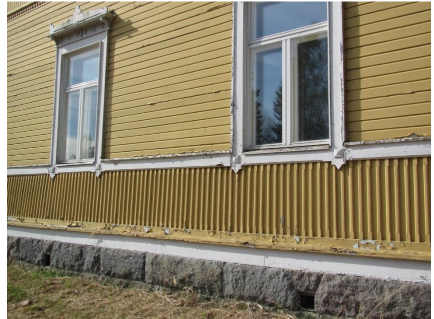
Tyypillinen teollisen maalin käytön aiheuttama virhe on kallis ja työläs korjata. Kuva Päivi Andersson 2016.
